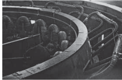
Рис. 1. Вид сверху на гидрогенератор 16.9 МВ А, 110 кВ
